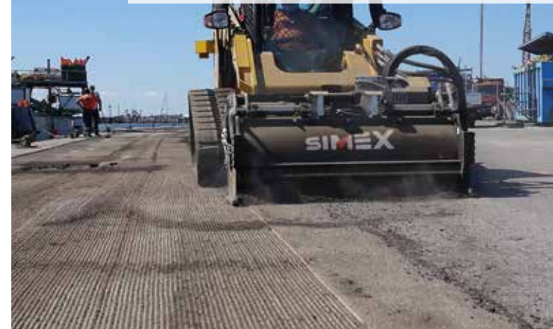
PL 60.20 am Kompaktlader Abtragen der gesamten Asphaltsschicht als Vorbereitung für den anschließenden Aushub.
